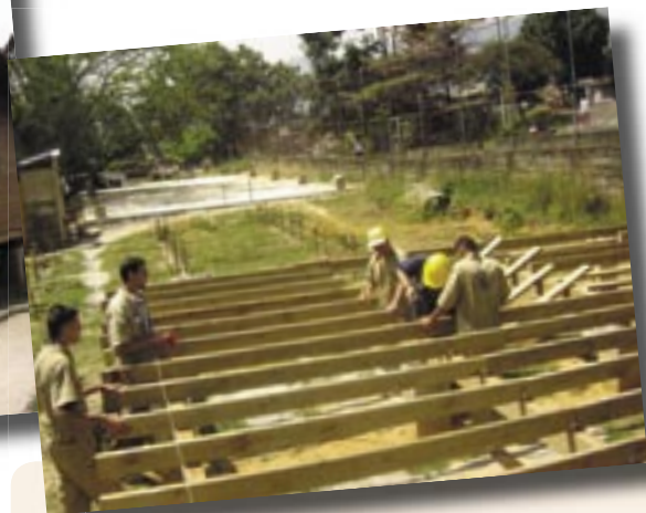
Izquierda: Viviendas en madera, construidas por los aprendices, con capacidad para albergar a seis de ellos. Derecha: Aprendices del área de Carpintería para la construcción, en una de sus prácticas de formación.
